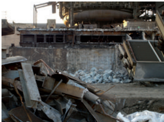
Der Zerstörung wertvoller Teile der Anlage muss Einhalt geboten werden!
