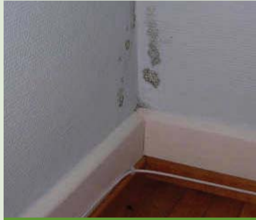
Warum ist die Fußleiste in dem Beispielfoto eigentlich nicht verschimmelt? Durch die Dämmwirkung des Holzes ist auf der Innenseite eine höhere Temperatur. So kann dort kein Schimmel wachsen.
