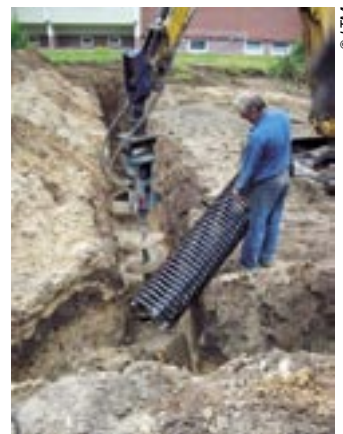
Flächenkollektoren einer Wärmepumpe
