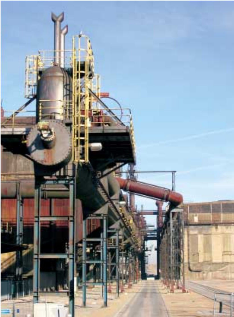
Die Gasleitungen: sie stellen das Rückgrad der Anlage dar und müssten unbedingt erhalten bleiben: da sie die Funktionalität der Anlage darstellen und auch ein urbanistisches High-Light sind. Dies zumal die Kosten hierzu sehr niedrig ausfallen (gemäß Berechnungen, die im Auftrag von "sites et monuments" durchgeführt wurden, 200.000 €!). Hier müsste auch die Gemeinde Esch ihre Verantwortung übernehmen. (Foto Lex Kleren)
