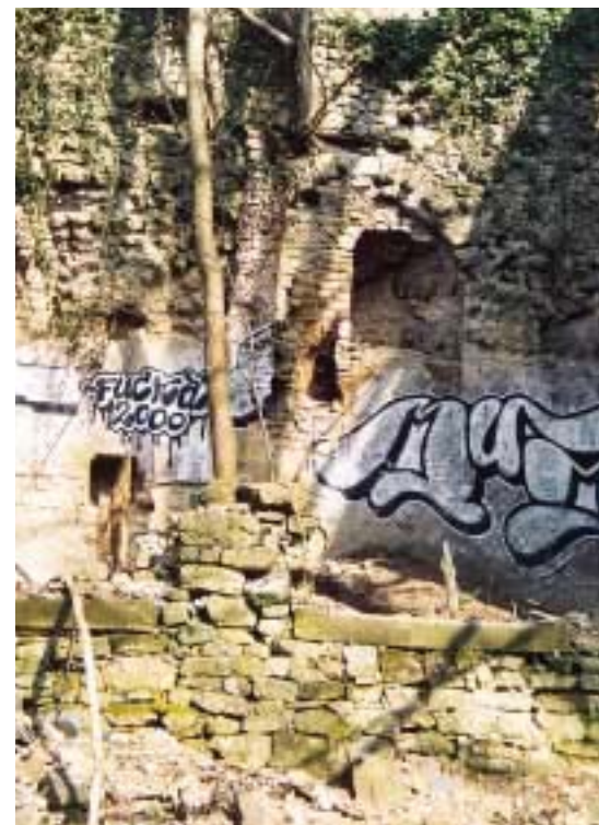
Wildwuchs im Bereich des Kryptoportikus, einem überwölbten Gang mit Rundbogennischen (hier: vermauert) lassen nichts mehr von der prachtvollen Ausstattung des 16. Jahrhunderts ahnen
