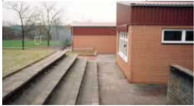
Vorher: Eine abscheuliche und gefährliche Betontreppe
