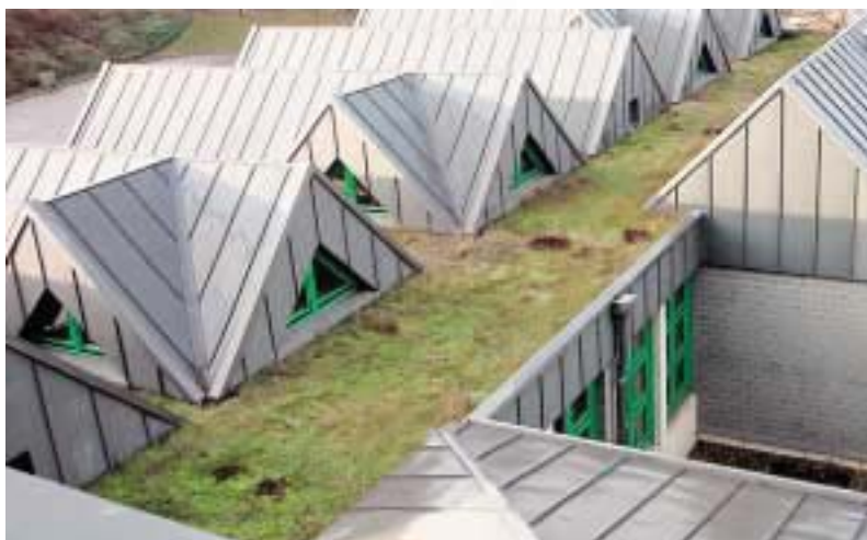
Bild 3 Dachbegrünung und Regenwassernutzung in einer Schule in Schifflingen (L). In einem weiteren Schulprojekt in Schifflingen werden momentan wasserlose Urinale System "Ernst" eingebaut.
